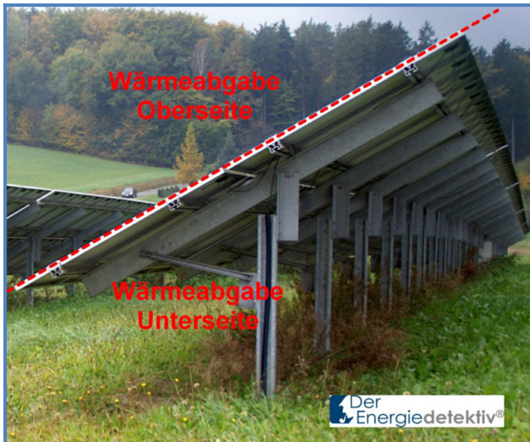
Bild 5: die Wärmeabgabe an einer Photovoltaikanlage erfolgt sowohl an der Oberseite als auch an der Unterseite der Paneele
